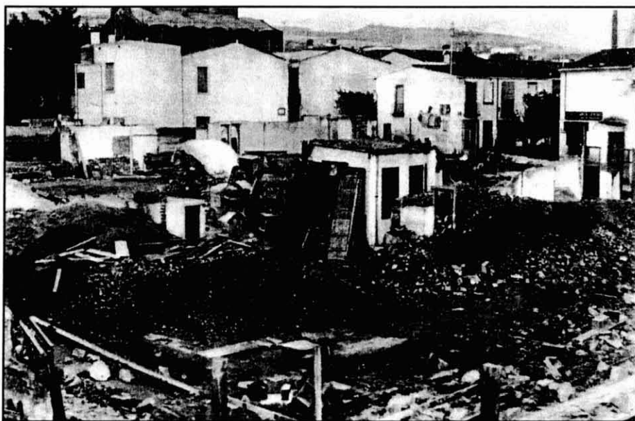
Enderroc de les cases de la Riera Buscarons per a l'edificació de la Plaça Mercat
