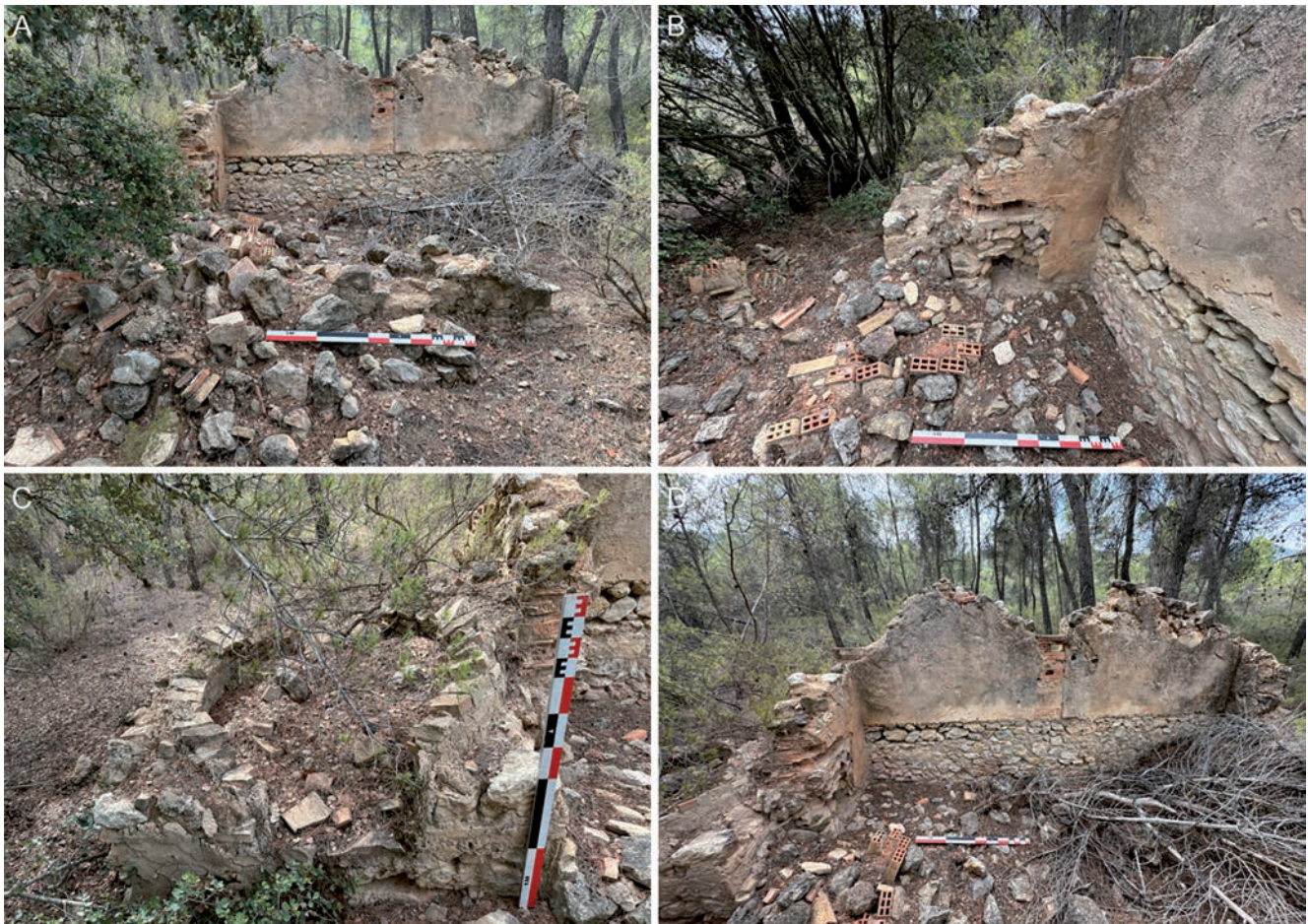
Figura 8. A) Vista frontal de la cocina; B) Alzado noreste; C) Vista general del horno moruno; D) Vista interior del alzado sureste.
