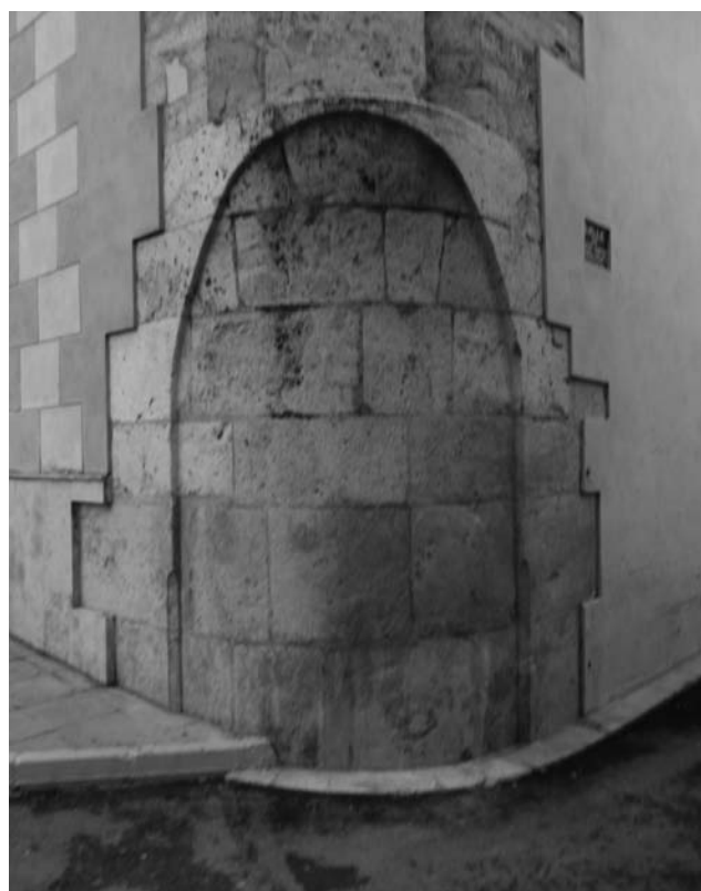
Figuras 8 y 9. Sillares de piedra en la base de la torre y una de las esquinas de la Iglesia. Fotografías: autor.
