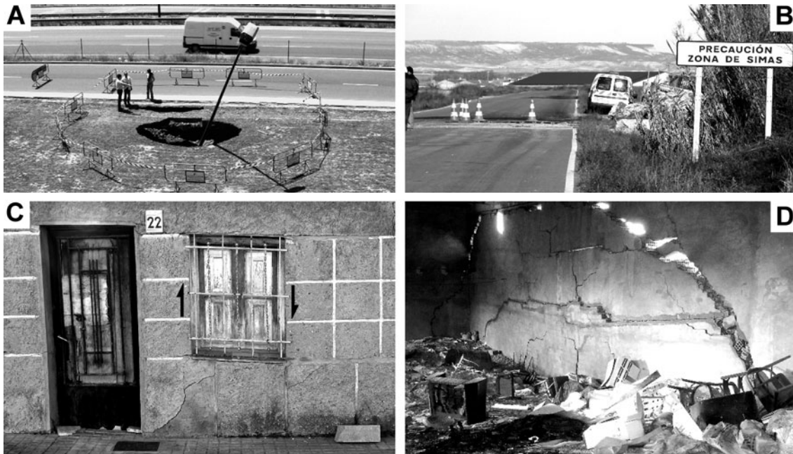
Fig. 8. Afecciones por dolinas en zonas urbanizadas e infraestructuras. (A) Pequeña dolina de colapso junto a la autovía A-68, W de Zaragoza. (B) Carretera CV-615 de acceso a Luceni, NW de Zaragoza. (C) Fachada de vivienda en el barrio de Miralbueno (Zaragoza), con la ventana y la puerta 'cizalladas' por hundimiento diferencial y afectada por fracturas en su base. (D) Interior de edificación en Luceni, que muestra un combamiento de la solera y una gran fractura en bóveda.
