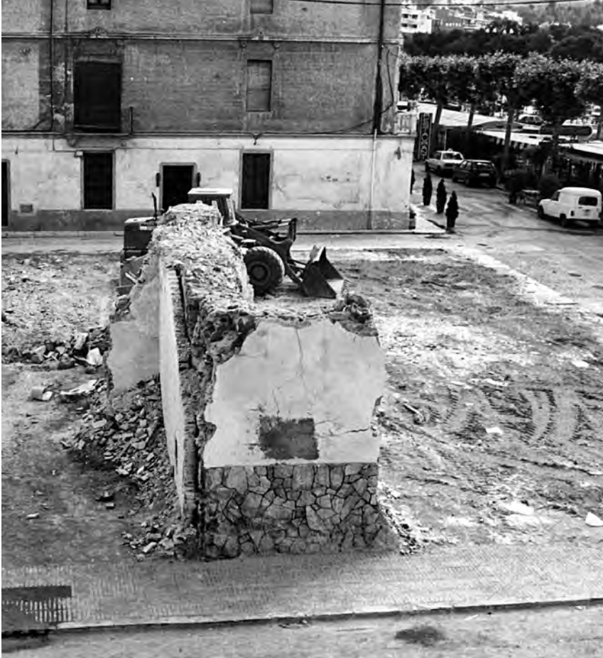
Fig. 14. Restes del tram sud de muralla vistes des de la plaça del Mercat, a l'alçada de l'edifici de l'Ajuntament, durant les obres d'enderroc prèvies a la construcció d'un bloc de pisos. Al fons, el passeig del Mar (AMSFG. Fons Ajuntament. Autor desconegut).
