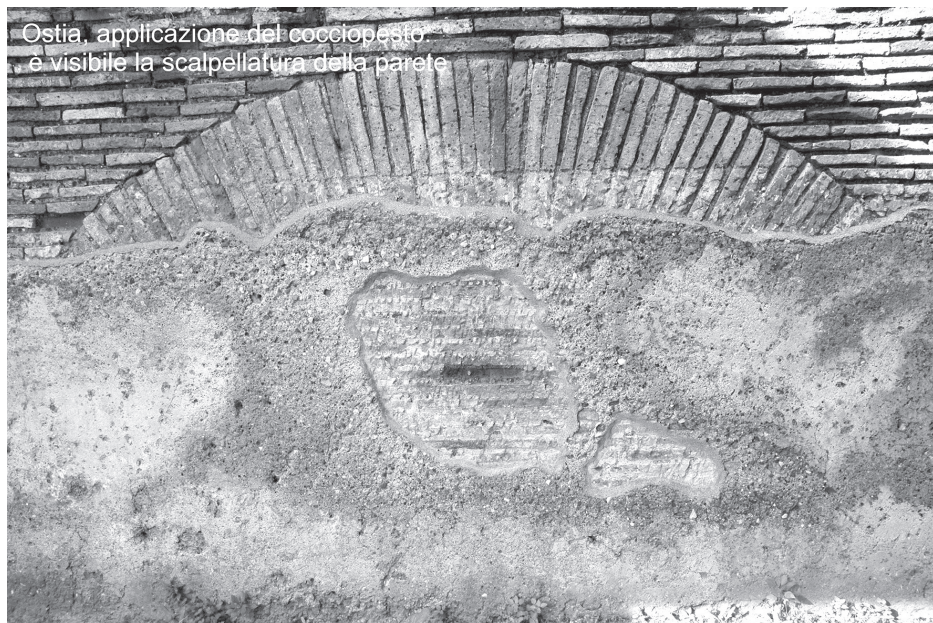
Figura 4. Revestimiento en cocchiopesto (o si se prefiere ostracus o testaceum o pavimento de cascotes) (GIULIANI 2006).
