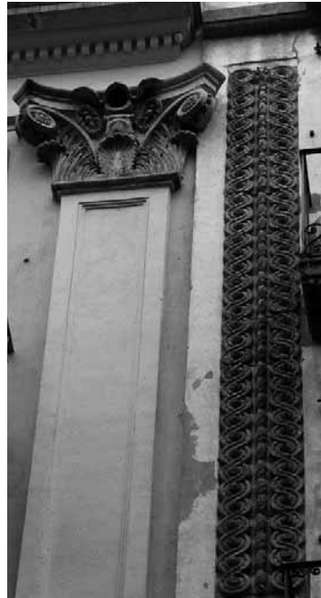
Figura 2. Elements d'ornamentació arquitectònica en terracota al carrer del Carme, núm. 23 (F. Daniel Molina, 1851) i 25 (J. Casademunt, 1852). Punt de contacte entre els dos immobles.
