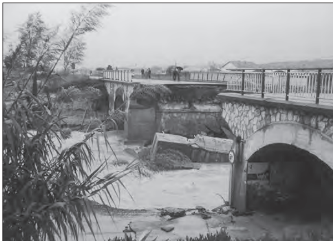
El pont de la carretera ensorrat per la riuada del 10 d'octubre de 1994.
