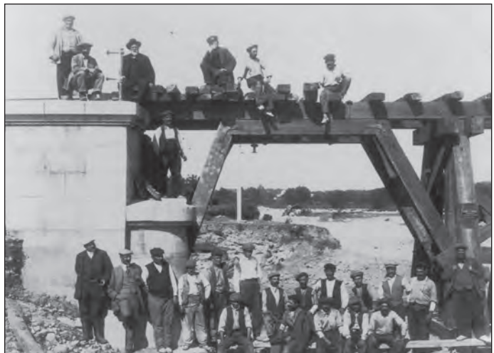
Gent que muntava el pont de fusta del pont de la via del tren de Cubelles, després de la riada del 29 de setembre de 1913.
