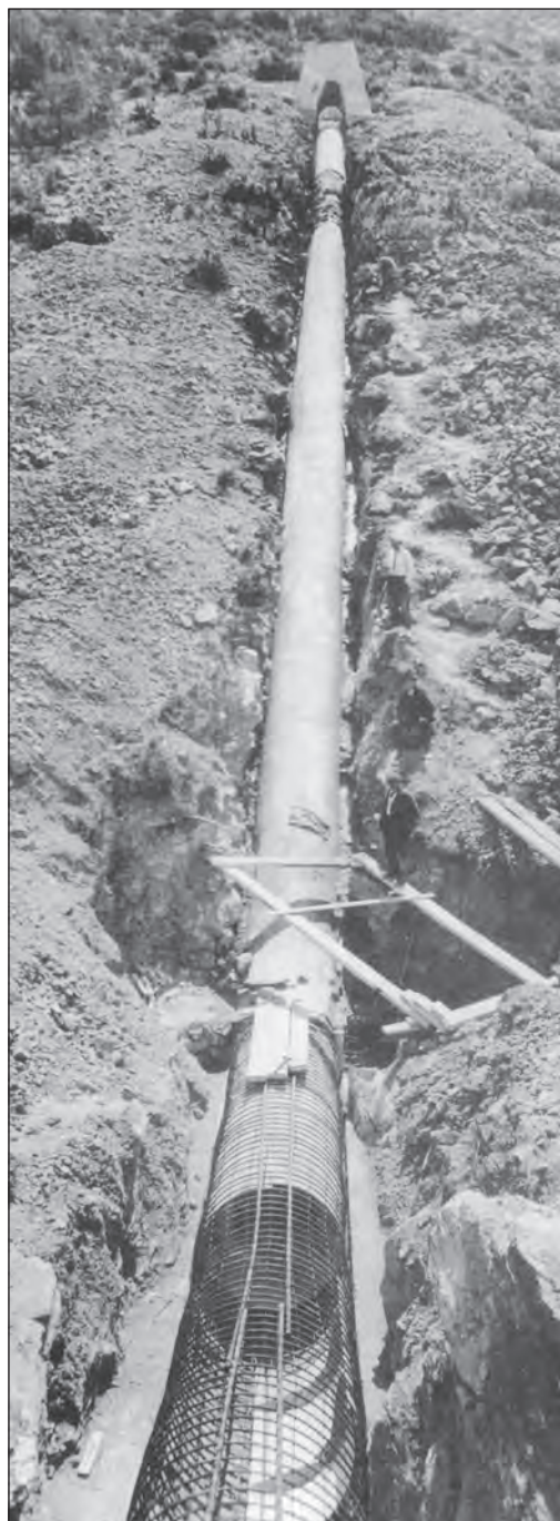
Canonada d'un sífó per salvar el pas dels canals entre turons
