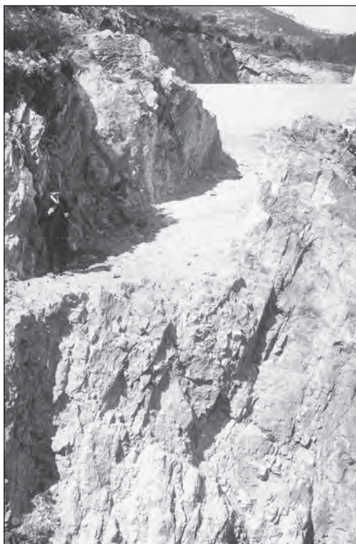
Un dels avencs que es van trobar en l'acondicionament del vas del pantà.
