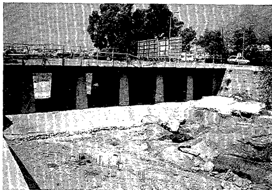
Foto 7: Pont de la carretera de Benitatxell sobre el riu. Obres de reforç del basament després de l'avinguda de 1989, deteriorades en l'actualitat.
