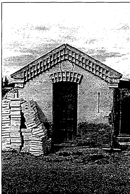
Frontal de la caseta de distribució.
