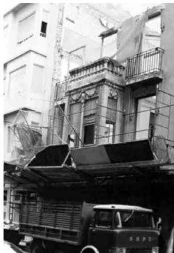
Fig. 12. Enderroc d'una casa modernista. Carrer del Capità Lagier.
