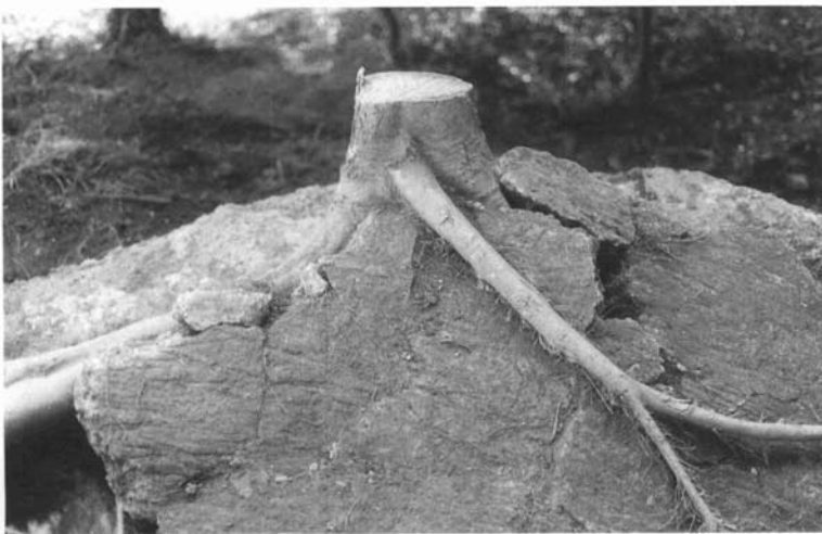
Destrucció d'un paviment d' opus testaceum per les arrels d'un lledoner. Fotografia: Estrat, SCP.
