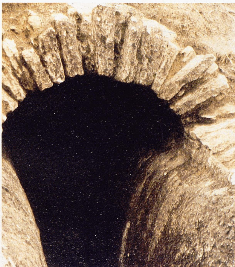
Galeria d'un aqüeducte romà a Nemausus. Fixeu-vos en les adherències de calç.
